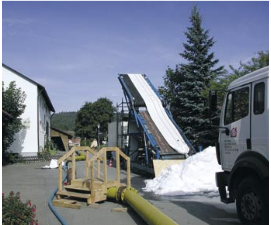
Besondere Geschicklichkeit war in Hausen erforderlich, um den Anwohnern angemessene Querungsmöglichkeiten über die Trasse der Wasserhaltung zu ermöglichen.
