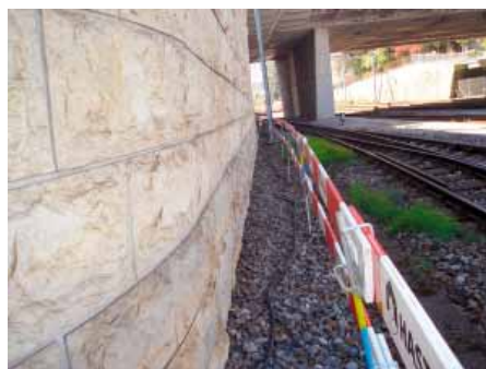
Beengte Verhältnisse für die Schachtzugänge.
