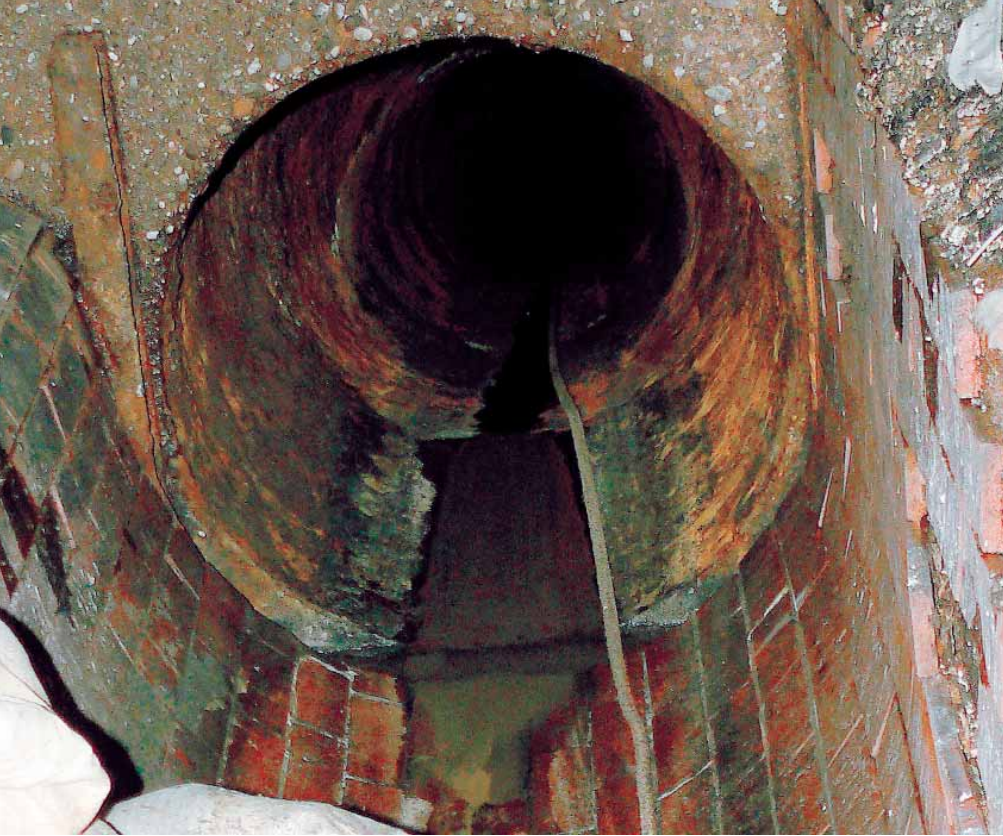
Ein Strang des Rur-Dükers vor der Sanierung: Schwer gezeichnet durch Korrosion.
