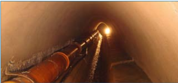
Beschichteter Kanal mit innenliegender Wasserhaltung
