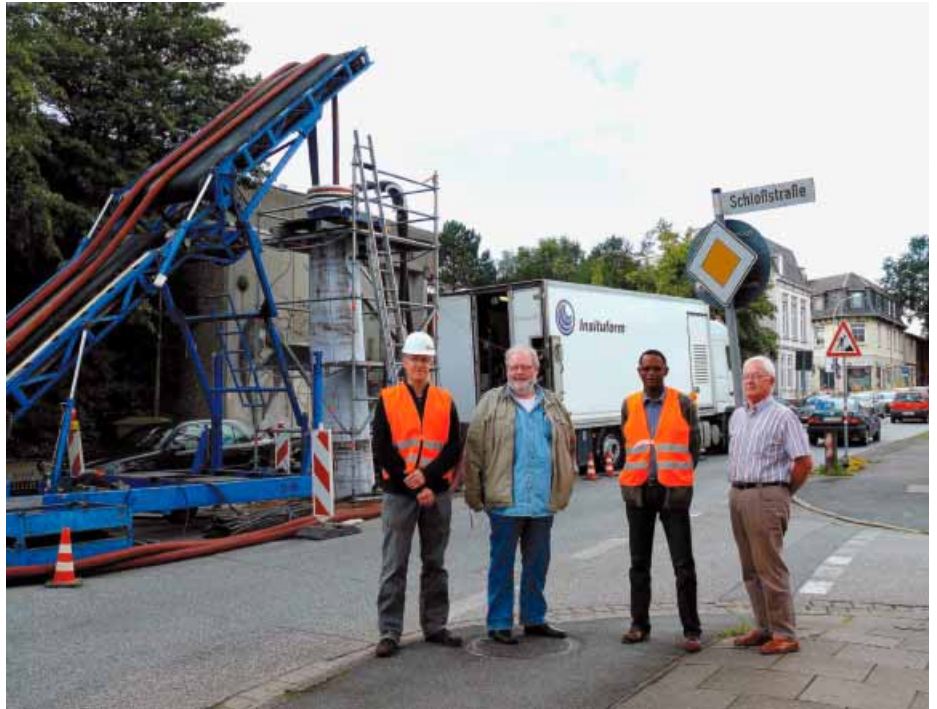
Die „Macher“ der diesjährigen Schlauchliner-Sanierung in Pinneberg vor der Kulisse des aushärtenden Liners (v. links): Insituform-Bauleiter Dipl.-Ing. Stefan Ehrich, Dipl.-Ing. Volker Jürgens, Abwasserbetriebe Pinneberg, Dipl.-Ing. Tharcisse Gakumba vom IBB Ingenieurbüro und Dipl.-Ing. Dieter Baak, IBB Ingenieurbüro
