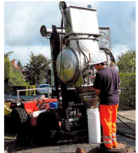
Linerinstallation unter extremen Verkehrsbedingungen: An der Mühlenstraße ging es tagsüber sehr eng zu.
