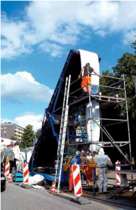
Über den Insituform-typischen Förderturm wurde an der Mühlenstraße ein Inliner DN 700/1050 installiert.
