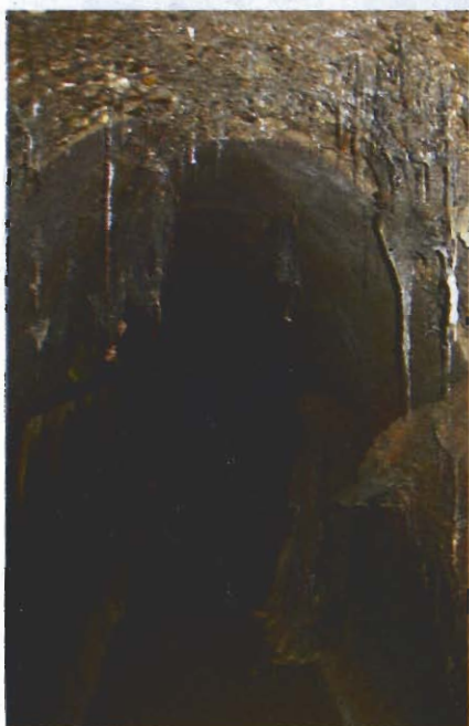
1 Der Kanal vor der Sanierung
