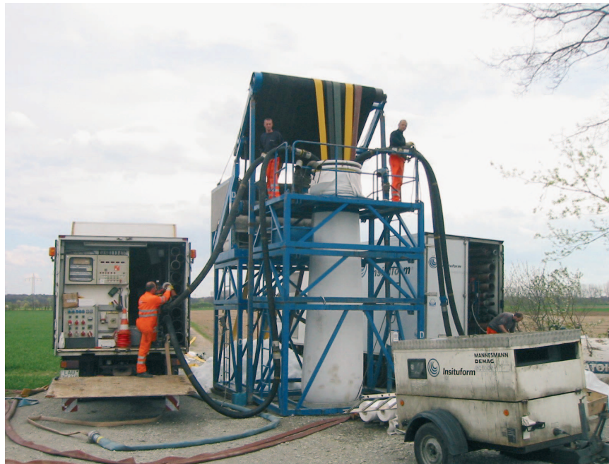
Abb. 2 Zwei Heizanlagen sorgten gemeinsam für eine dem Zeitplan gemäßige Erhitzung und Zirkulation des Wassers in dem Liner DN 1100.
