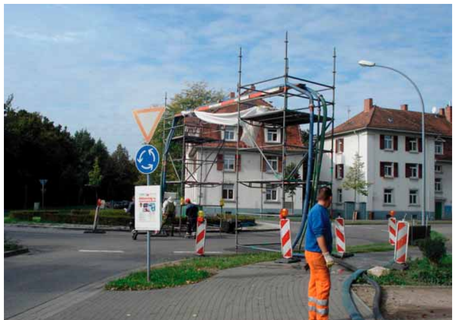
Diesen stark befahrenen Verkehrskreisel mussten die Schläuche der Heizanlage auf einer eigens installierten Rohrbrücke überqueren.
