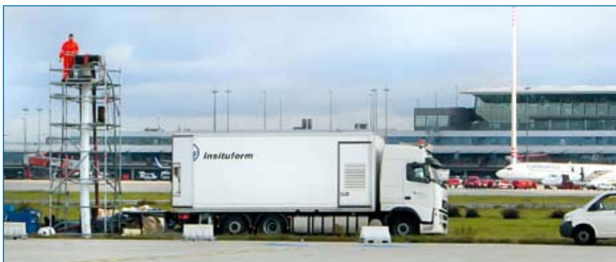
Im Bereich der Vorfelder kam das klassische Insituform-Verfahren mit Warmwasserhärtung zum Einsatz.
