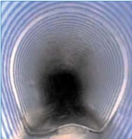
Bild 3: Querschnittsdeformationen der vorhandenen Rohrleitung vor der Sanierung, BV Waiblingen
